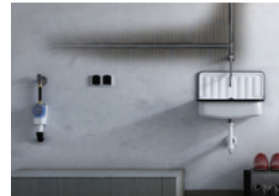
↑ NEVYUŽÍVANÉ VODOVODNÍ POTRUBÍ
